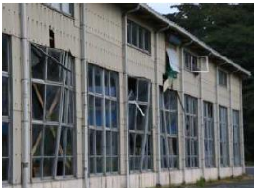
外壁の傾斜、破損
