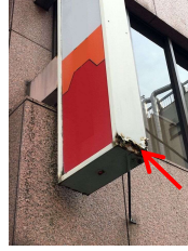
広告板底部の腐食が進行した状態
