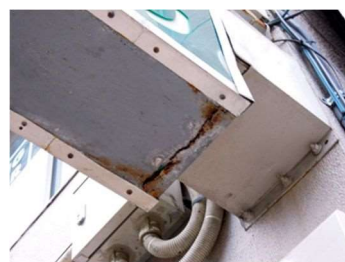
側板底面が破損した状態
