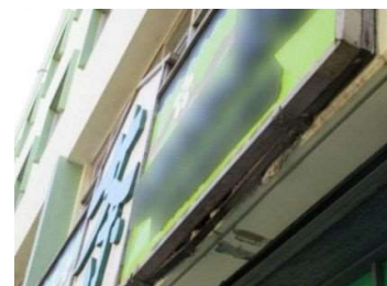
側板底面が破損した状態
