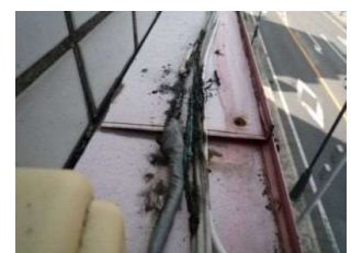
配線が劣化し、ショートした状態
