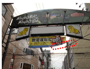
幕材を張る部材が破損した 状態
