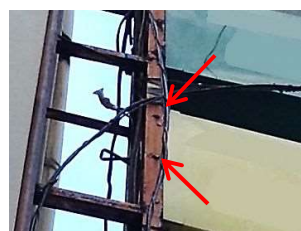
ボルトのゆるみや欠落した状態
