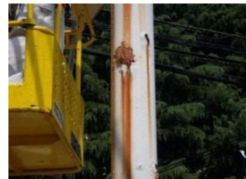
支柱の腐食が進行した状態
