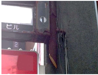
支持部が腐食した状態
