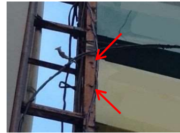
ボルトのゆるみや欠落した状態
