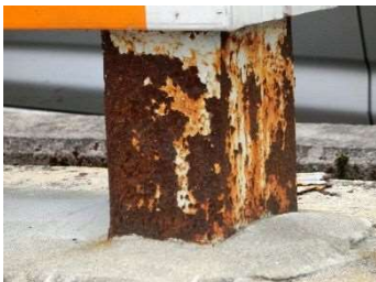
支柱根元の腐食が進行した状態
