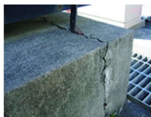
基礎にクラックが入った状態
