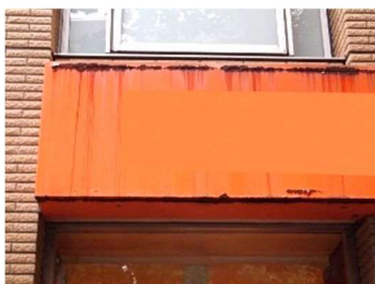
側板の腐食が進行した状態
