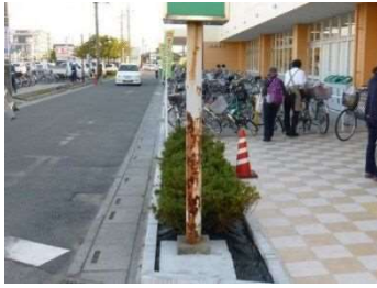
支柱の腐食が進行した状態
