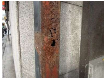
支柱の腐食が進行した状態
