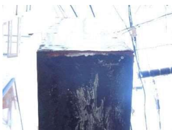
側板底面にさびが発生した状態
