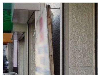
壁面との間に隙間が生じた状態
