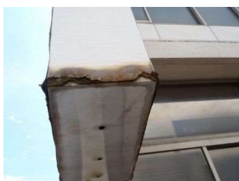
側板の腐食が進行した状態
