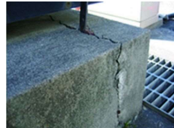
基礎にクラックが入った状態
