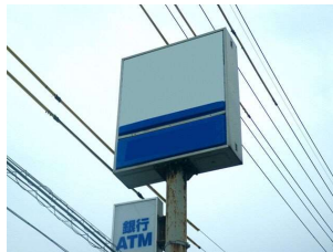
鉄骨接合部（溶接部）が腐食している状態
