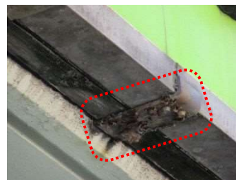
金具が劣化した状態
