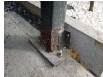
支柱根元の腐食が進行した状態
