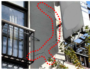
壁面にひびが生じた状態
