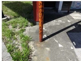
支柱の腐食が進行した状態
