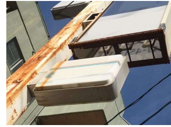
支柱にさびが発生した状態
