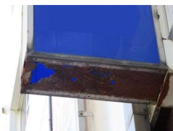
側板底面が腐食、破損した状態
