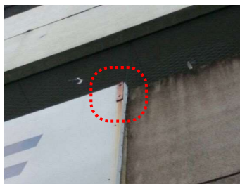
金具が劣化した状態
