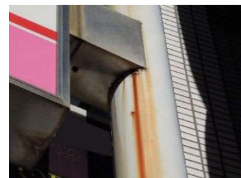
支柱・ブラケット接合部に汚ダレが見られる状態
