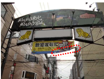
幕材を張る部材が破損した状態
