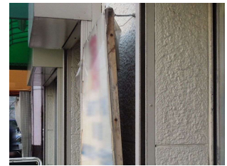
壁面との間に隙間が生じた状態
