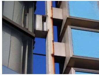
支持部が腐食した状態
