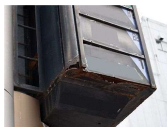
側板底面が腐食、破損した状態
