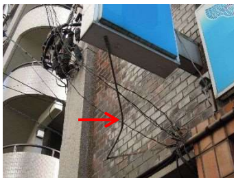
振れ止め棒が変形した状態
