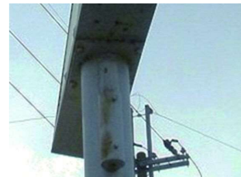
支柱・広告板接合部にさびが発生した状態
