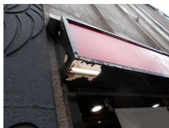
側板底面の腐食が進行した状態
