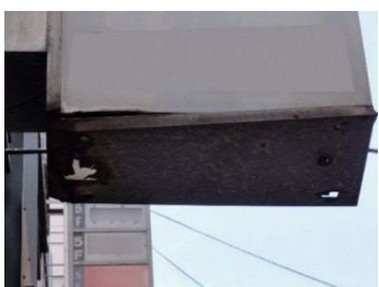
側板底面が腐食、破損、変形した状態
