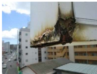
側板の腐食が進行した状態
